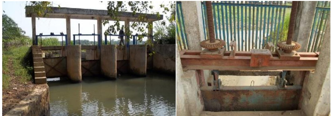
Gambar 4 Pintu skot balok
